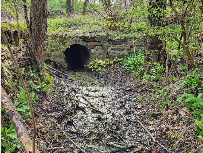
Foto 2: Historisches Zschampertbett und Durchlass unter der B186, zwischen Dölzig und Schkeuditz - Kathleen Burkhardt-Medicke
